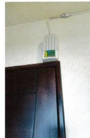
201 房間緊急照明燈
