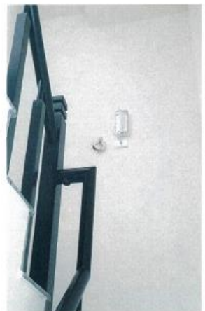
2F 樓梯緊急照明燈
