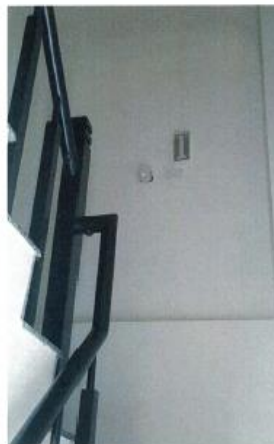
3F 樓梯緊急照明燈
