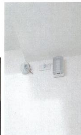
1F 樓梯緊急照明燈
