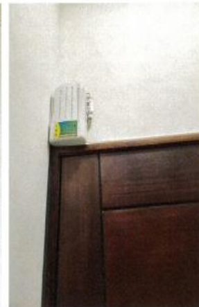
202 房間緊急照明燈
