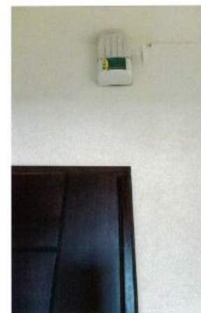
301 房間緊急照明燈
