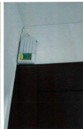
302 房間緊急照明燈
